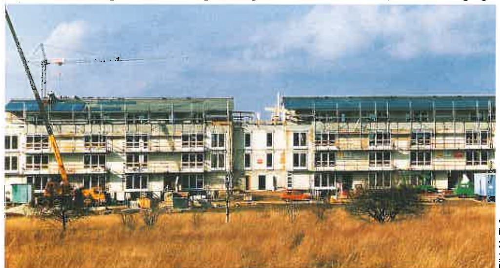
Moderne Wohnsiedlung in Neckarsulm mit großflächigen Kollektoren zur solaren Nahwärmeversorgung
